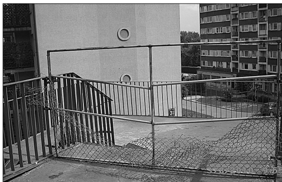
Mieszkańcy zerwali siatkę blokującą przejście przez kładkę przy ul. Mireckiego
